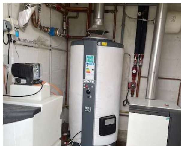
Réseau de chaleur
