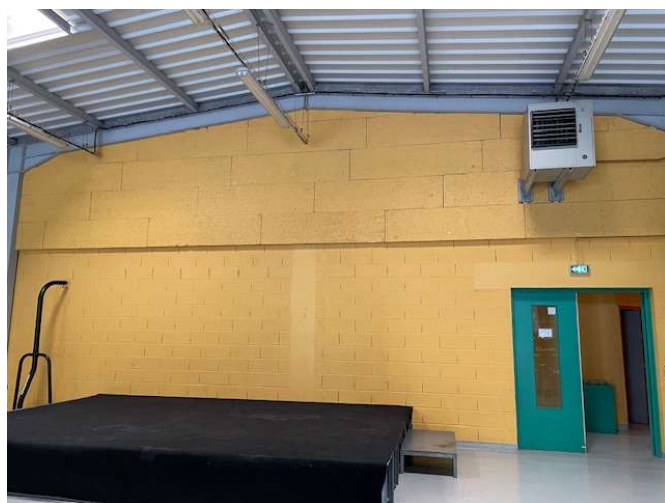
Système de chauffage
